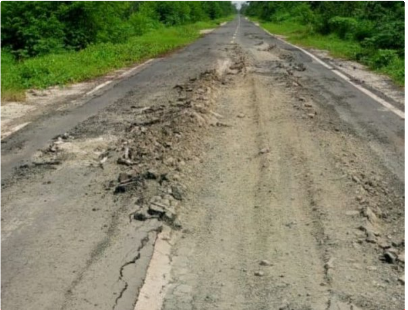
Gambar: Kondisi Terkini Jalan Mandomai - Mentangai Kabupaten Kapuas, Kalimantan Tengah
